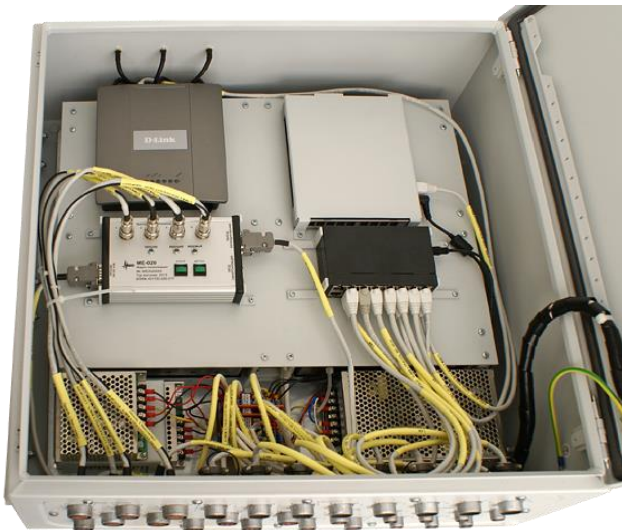
Рис. 5-Шкаф коммутации. Дверца открыта.
