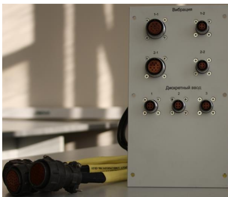
Рис. 7-Промежуточная коммутационная панель 1
